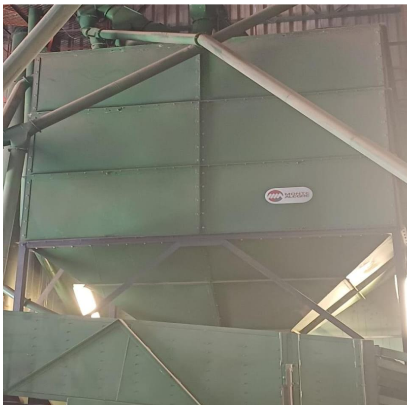
Figura 2: silo metálico 15 toneladas
